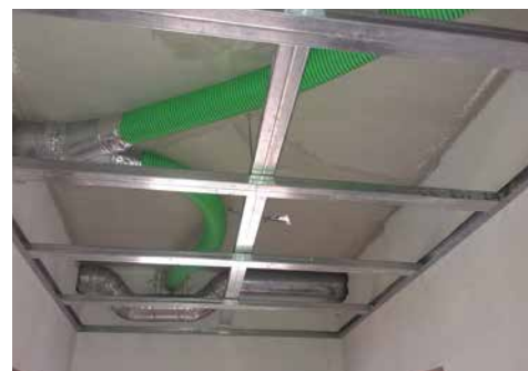
Část rozvodů v bytech – podstropní rozvod.
