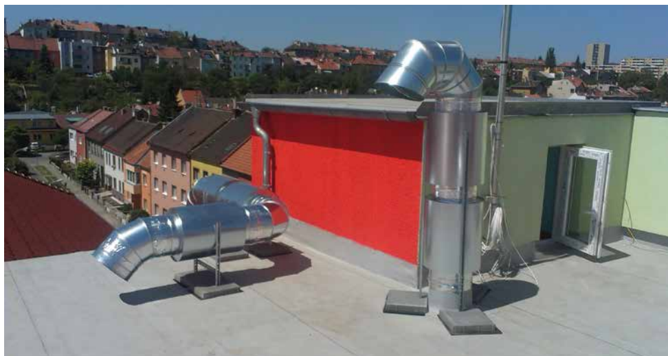
Sání a výdech nad střechou objektu.
