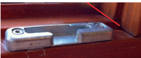
Kondenzace v okenních rámech a poškození konstrukce oken.
