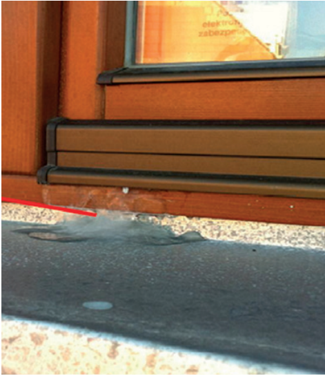
Kondenzace v okenních rámech a poškození konstrukce oken.
