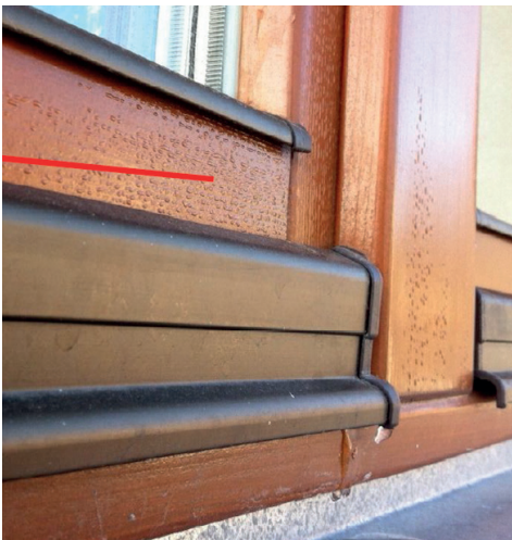
Kondenzace v okenních rámech a poškození konstrukce oken.
