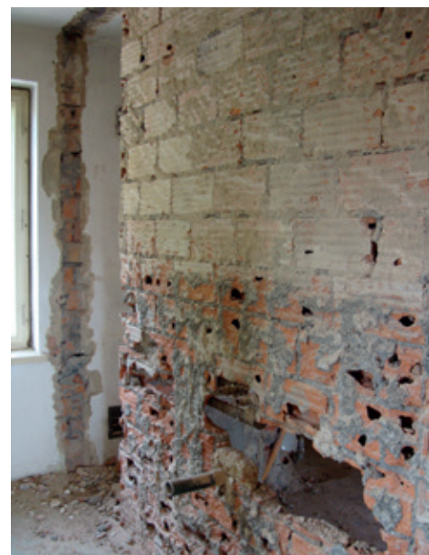
Příčky byly po odstranění původních obkladů v žalostném stavu. Nakonec se majitelka bytu rozhodla je vybourat a nahradit je ve stejném místě novými z moderního zdicího materiálu.
