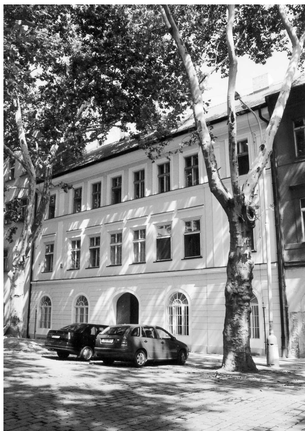
Oprava správní budovy našeho družstva v Kollárově ulici po loňské potopě se blíží ke konci.
